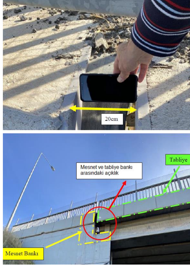
Görsel 6. Köprüde meydana gelen deformasyonlar
