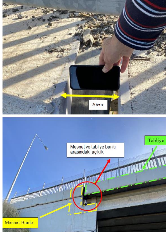
Görsel 6. Köprüde meydana gelen deformasyonlar
