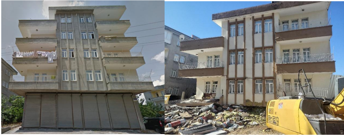
Görsel 2. İlk katının toptan göçmeye maruz kaldığı BA yapı örneği
