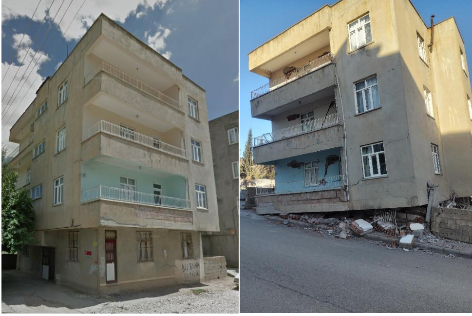
Görsel 3. Zemin katın toptan göçme örneği
