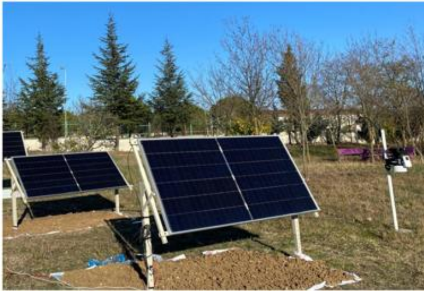
Görsel 1. Çift Yüzeyli Fotovoltaik Panellerin Toprak Zemin Üzerinde Kurulum Düzenegi
