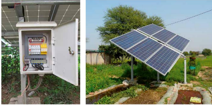
Görsel 2. Sağda: Dış Mekan Uygulamaları İçin Dizi Kabloları, Solda: Beton Temele Monte Edilmiş, Tek Eksenli Bir Güneş İzlemeli PV Sistem
