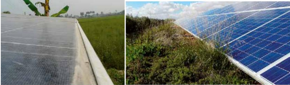
Görsel 8. Sol: PV Modülün Kirlenmesi, Sağ: Bitki Örtüsünün Gölgelemesi
