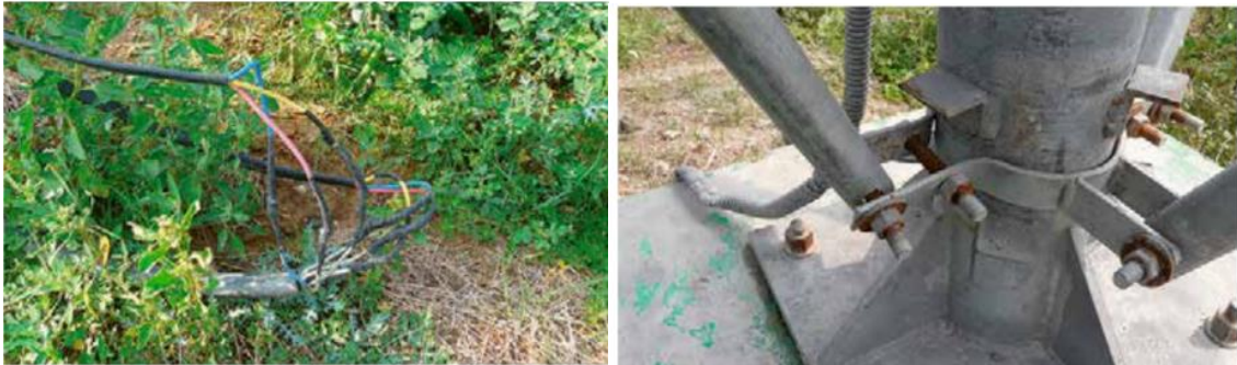
Görsel 6. Sol: Tehlikeli Kablo Bağlantısı, Sağ: İzleme Sistemi Korozyonu
