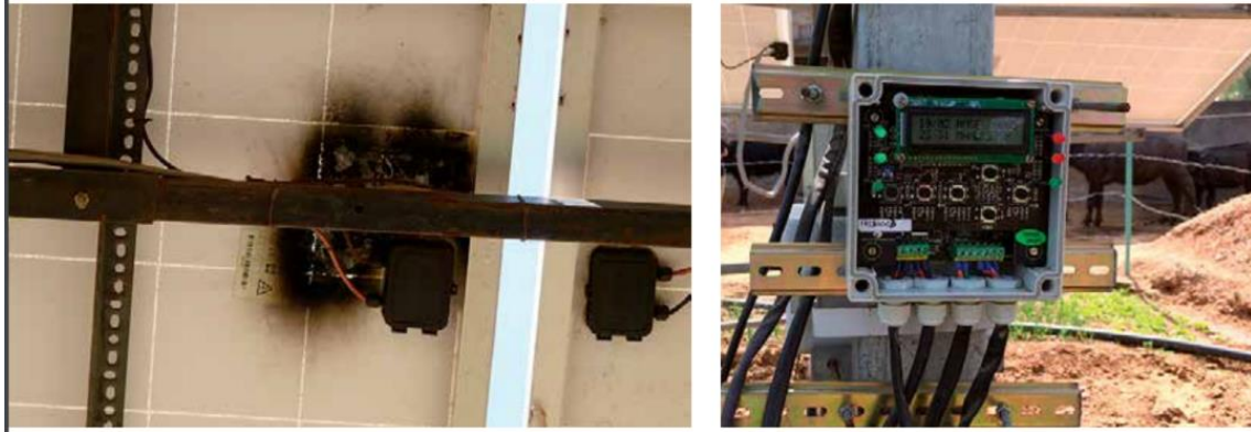
Görsel 3. Solda: Sıcak Nokta Etkisi Sağda: Arızalı Kontrol Ünitesi
